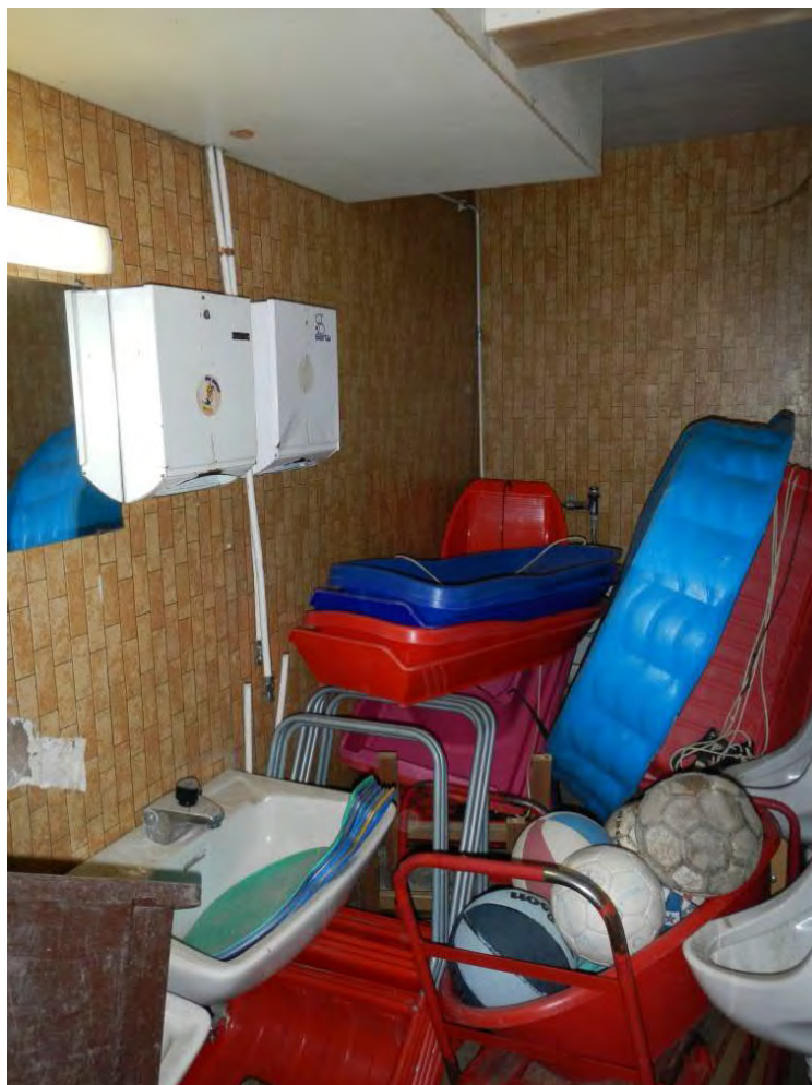
Osa rukoushuoneen märkätiloista on huonossa kunnossa.
