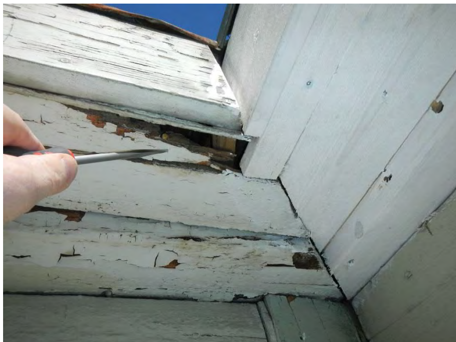
Rukoushuoneen räystäässä on havaittavissa pieniä lahoalueita.
