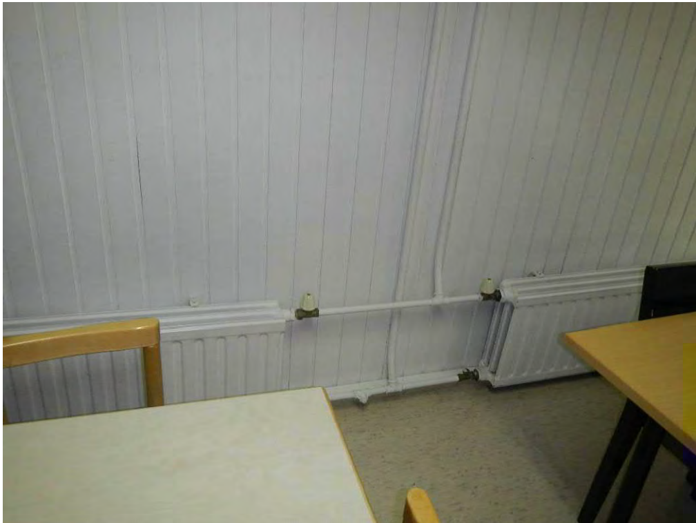
Rukoushuoneen patteriventtiilit ovat osittain käsisäätoventtiileitä.
