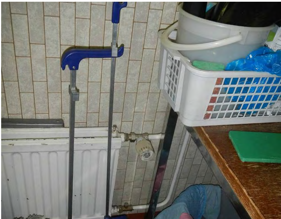
Rukoushuoneen patteriventtiilit ovat osittain teknisen käyttöään lopussa.
