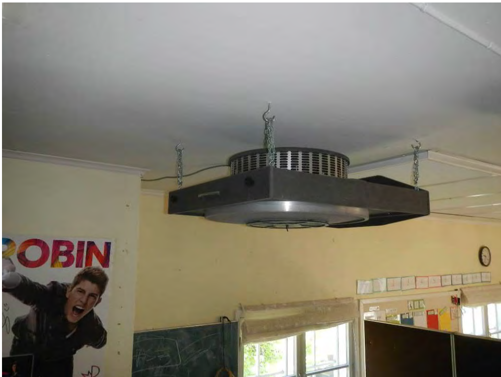
Ilmanpuhdistin päiväkodin tiloissa.
