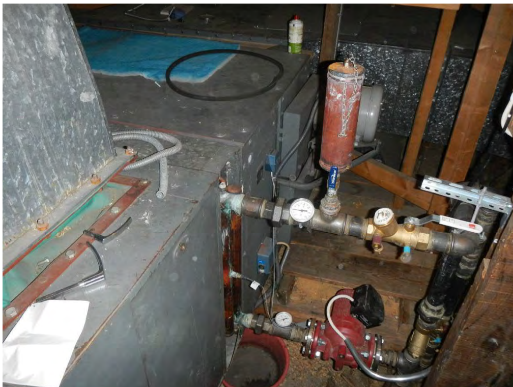
Rukoushuoneen IV- kone on heikossa kunnossa ja teknisen käyttöiän lopussa.
