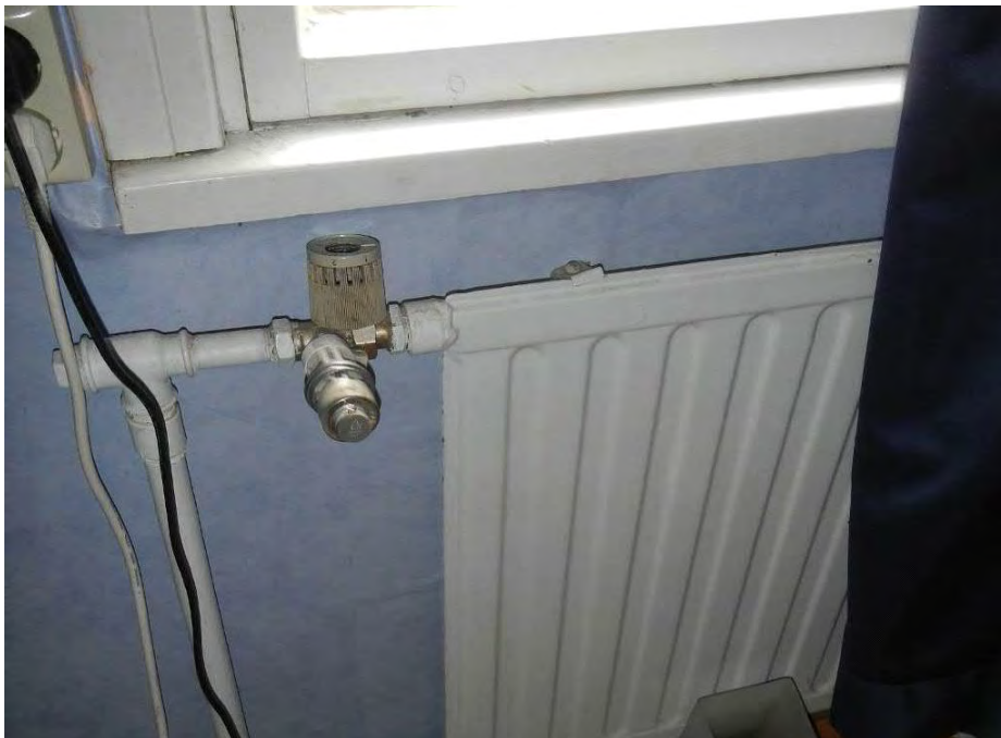
Omakotitalon patteriventtiilit ovat osittain teknisen käyttöään lopussa.
