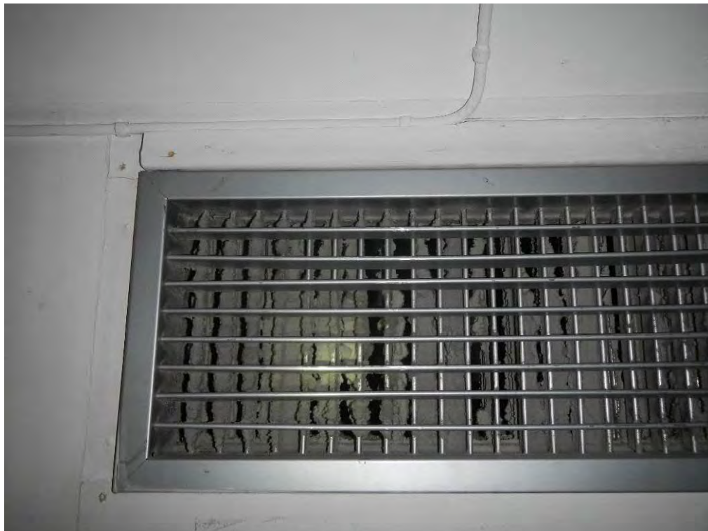
Rukoushuoneen ilmanvaihdon päätelaitteet ovat likaiset.
