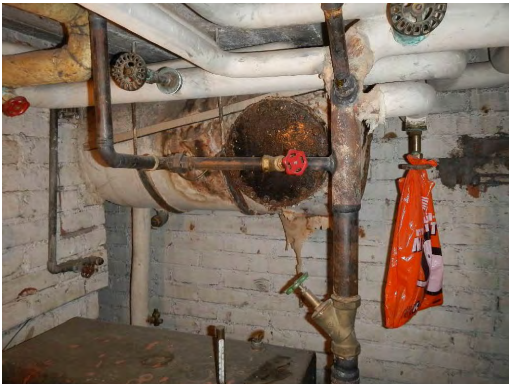
Omakotitalon kellarissa on rikkiäistä asbestieristettä.
