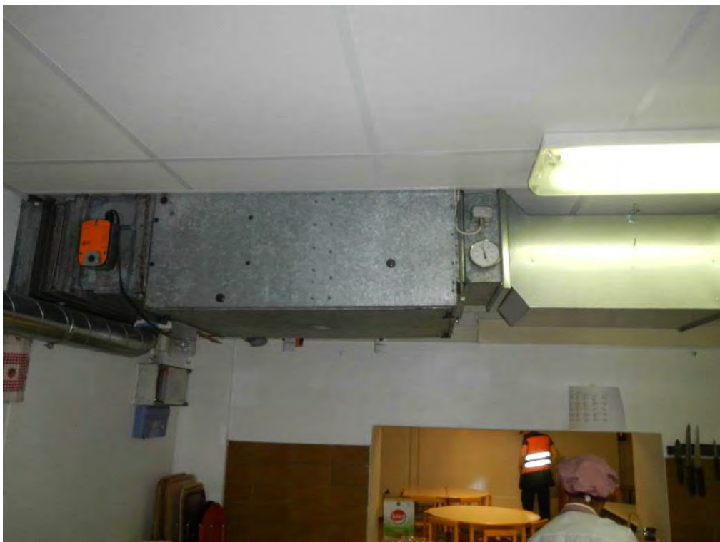
Rukoushuoneen keittiön tuloilmakone on teknisen käyttöiän lopussa.
