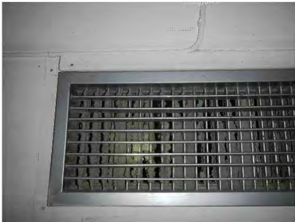
Rukoushuoneen ilmanvaihdon päätelaitteet ovat likaiset.
