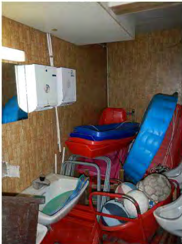
Osa rukoushuoneen märkätiloista on huonossa kunnossa.
