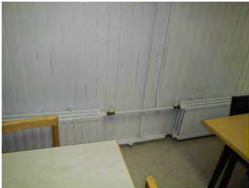
Rukoushuoneen patteriventtiilit ovat osittain käsisäätoventtiileitä.
