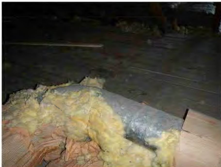
Rukoushuoneen ullakolla IV-kanavien eristys on puutteellinen.
