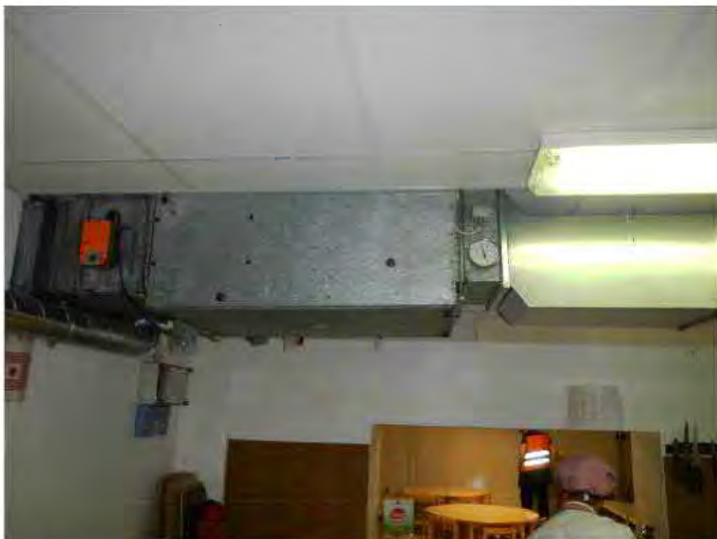
Rukoushuoneen keittiön tuloilmakone on teknisen käyttöään lopussa.
