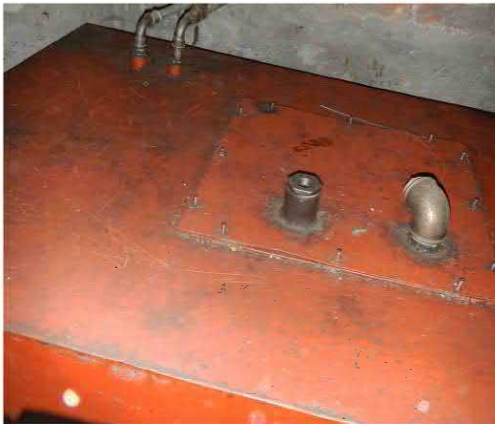
Omakotitalon kellarikerroksessa on vanha öljysäiliö, jonka puhdistuksesta ei ole tietoa.
