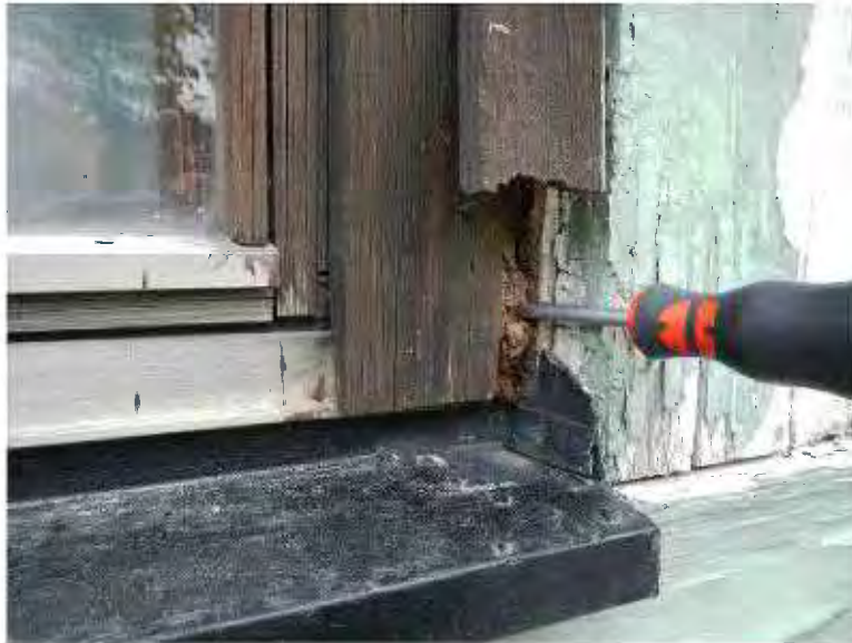
Omakotitalon ikkunan kunto on paikoin huono. Puun pinta halkeilee ja katkenneen listan kohdalta vesi pääsee seinärakenteen sisään.
