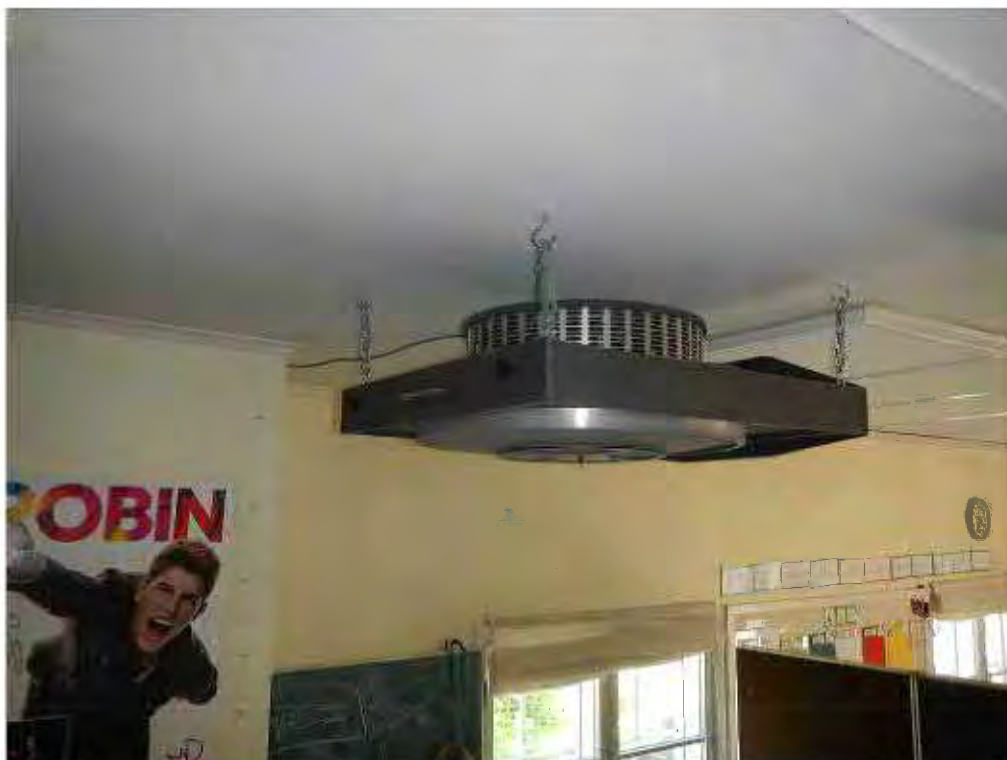
Ilmanpuhdistin päiväkodin tiloissa.
