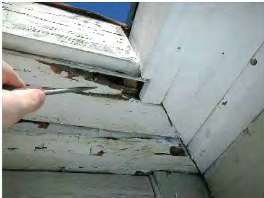
Rukoushuoneen räystäässä on havaittavissa pieniä lahoalueita.
