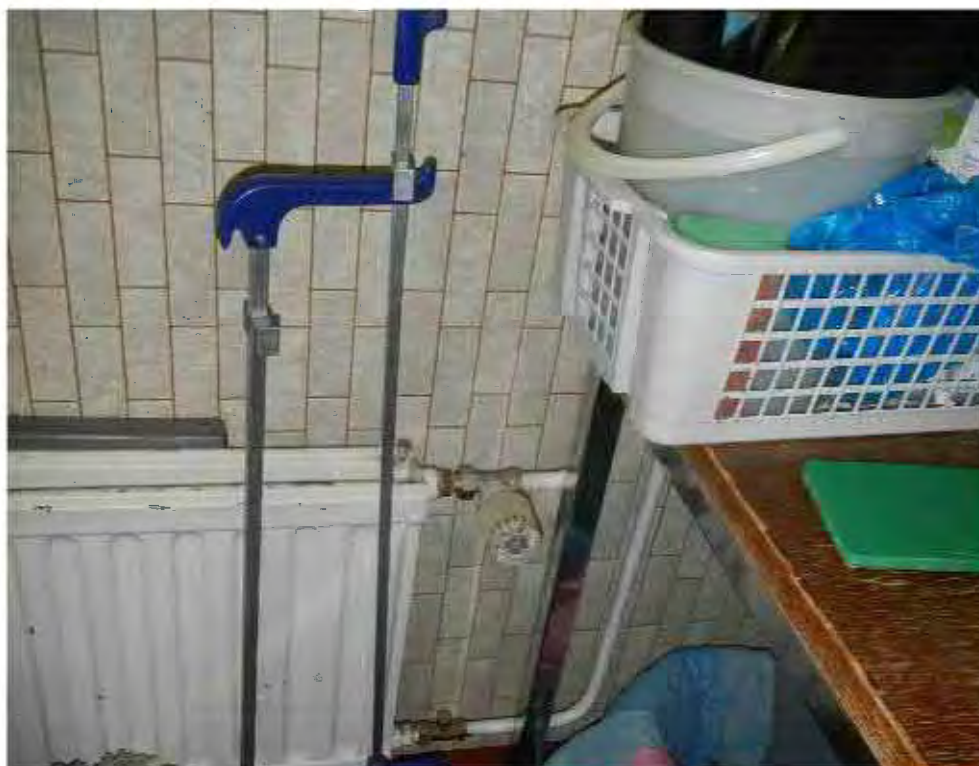
Rukoushuoneen patteriventtiilit ovat osittain teknisen käyttöään lopussa.
