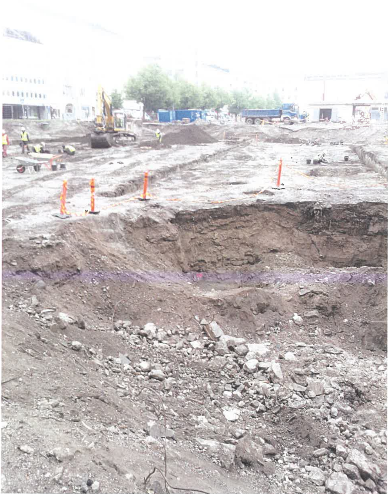
Kuva 1. Kuva pima-alueesta Rauhankadun puolella. Pilaantunut aines kuvassa näkyvästä pisteestä 43 vasempan.
