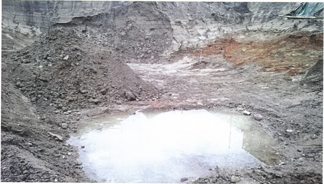
Kuva 1. Pima-kaivanto. Kuva otettu noin kohdalta 4 1 / 2 / E suuntaan luode. Oikeassa yläkulmassa, missä näkyy pressun alareuna, on Vapaudenkadun puoleinen kaivuuluiska.
