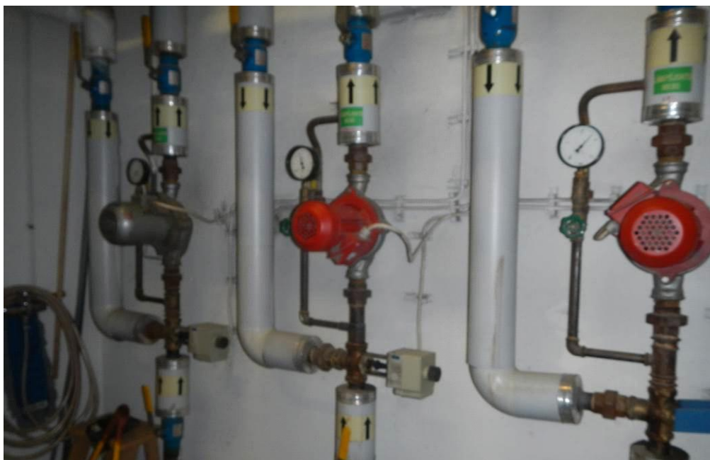
Yleiskuva kiinteistön lämmönjakokeskuksen pumppuryhmästä.
