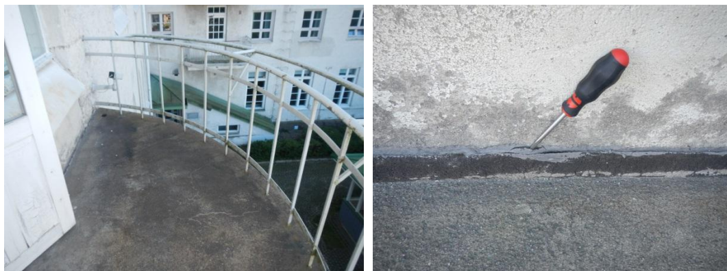
Parvekelaatassa on halkeamia. Parvekelaatan jalkalista on irronnut alustastaan.
