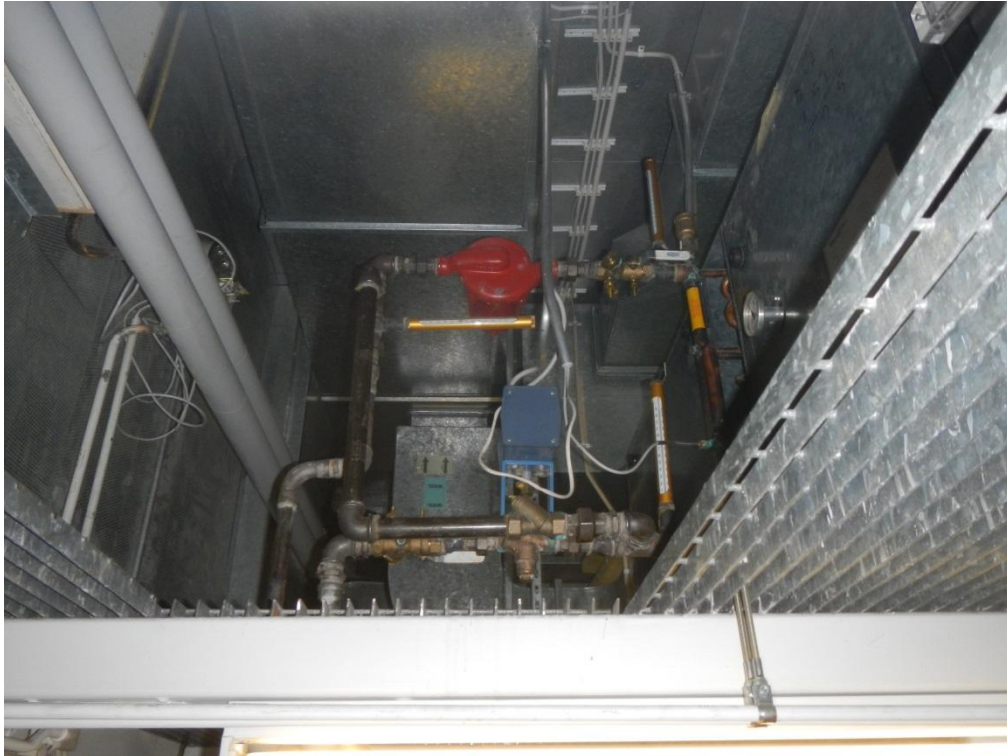
Auditoriota palveleva tuloilmakone. Ilmanvaihtokone on teknisen käyttöään lopussa.
