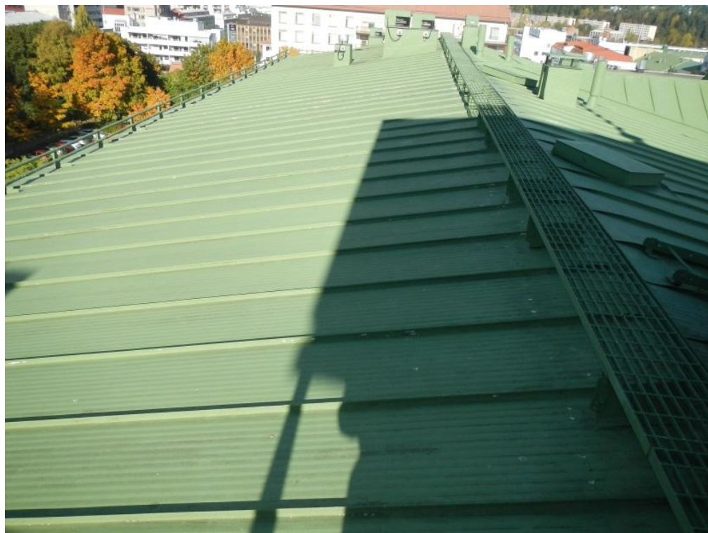
Katto on uusittu. Maalaus lohkeilee paikoitellen.
