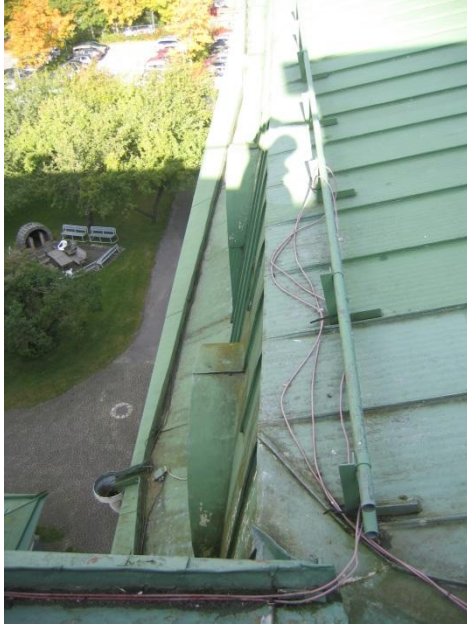
Lämmityskaapeleista puuttuvat kiinnityslistat.
