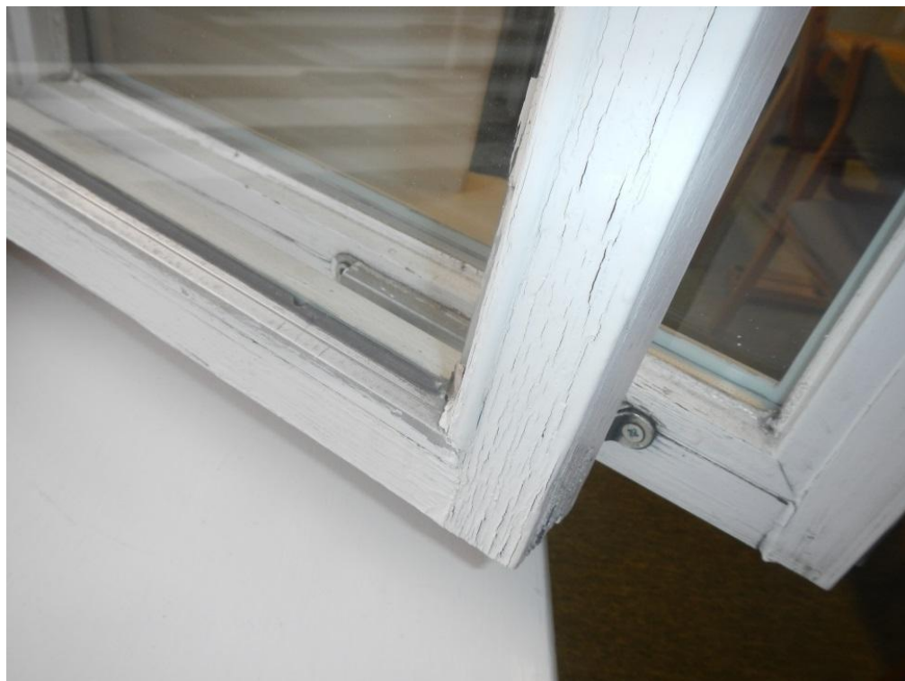
Uudemman ikkunan puitteiden ulkopinnan maalaus lohkeilee.
