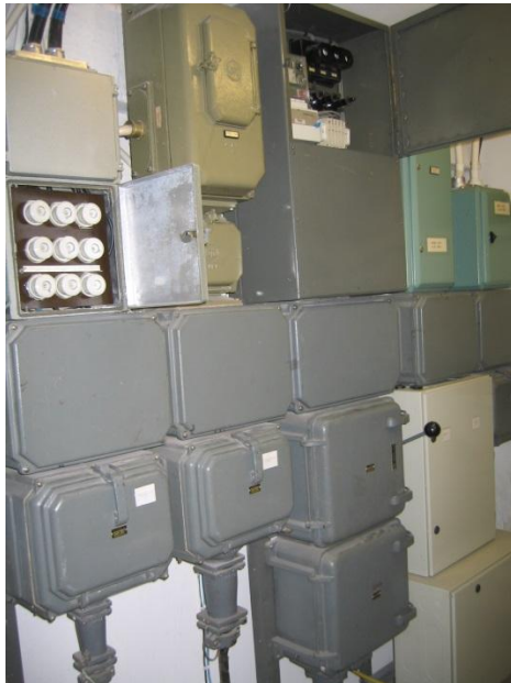
Kiinteistön pääkeskus 50-luvulta.
