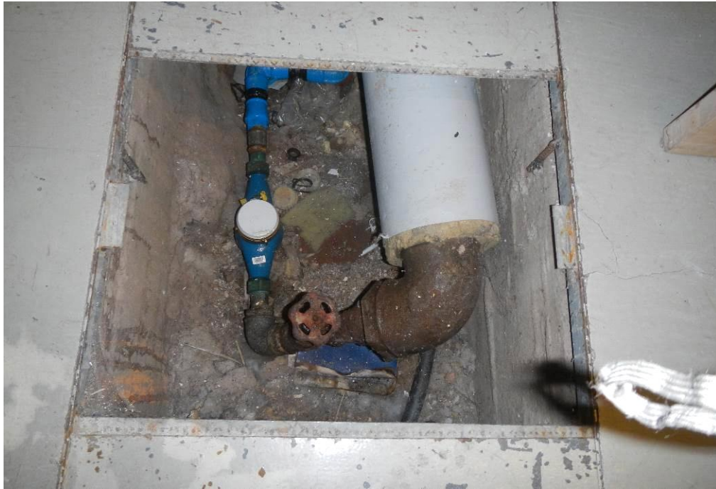
Käyttövesiverkoston pääsulkuventtiili ja vesimittari.
