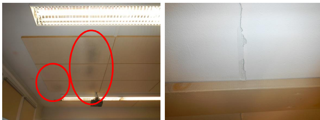
Pikkuveikkolan äänieristyslevyissä on tummia läikkiä. Luokkahuoneen seinässä on halkeama.
