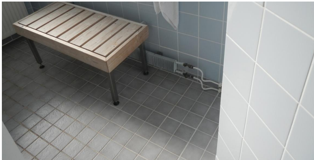
Yleiskuvat asuntolan pesuhuoneen kiertovesipatterista.
