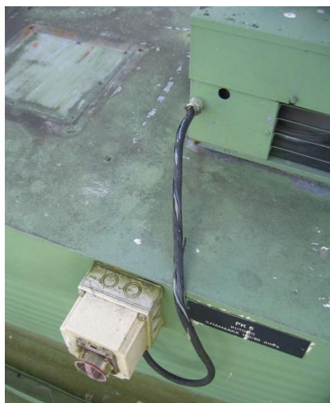
Poistoilmakojeen auringon polttama liitosjohto
