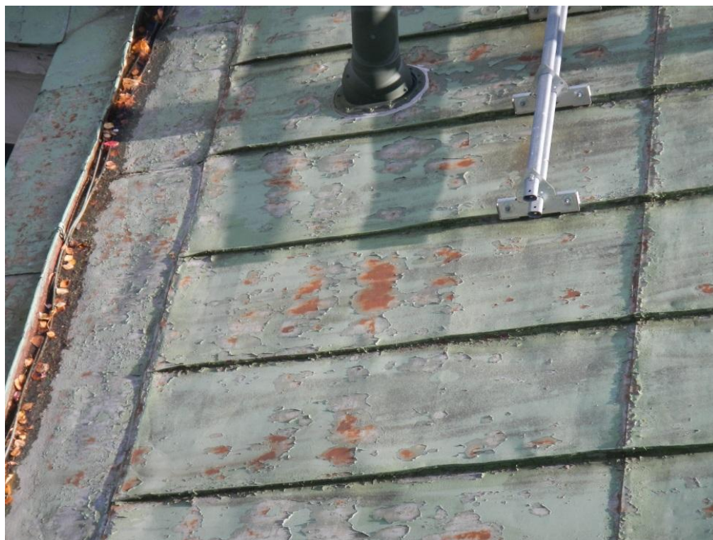
Palapeltikatto on ruostunut ja maalaus lohkeilee.
