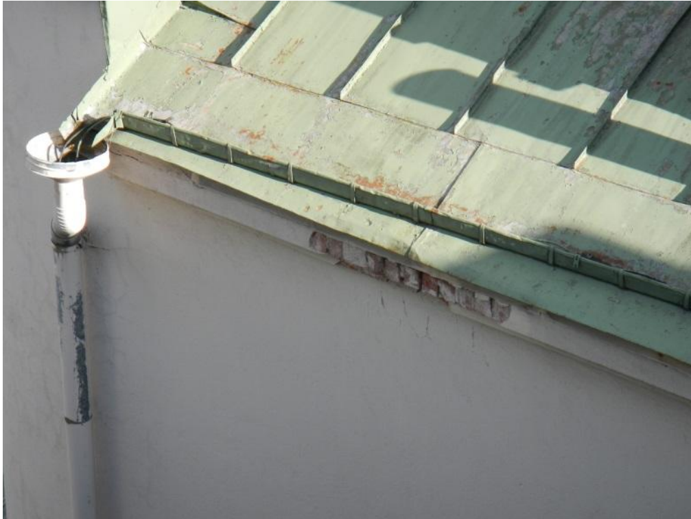
Jalkarännin ja vaakapellin pystysauma vuotaa, minkä takia räystäään rappaus lohkeilee irti.
