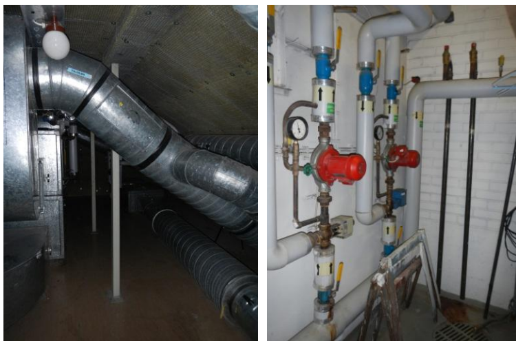
Ullakon IV-konehuone. Lämmönjakohuone.
