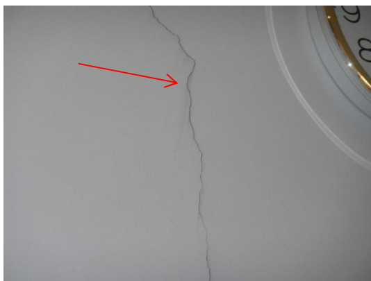
Toimiston seinässä on halkeama.
