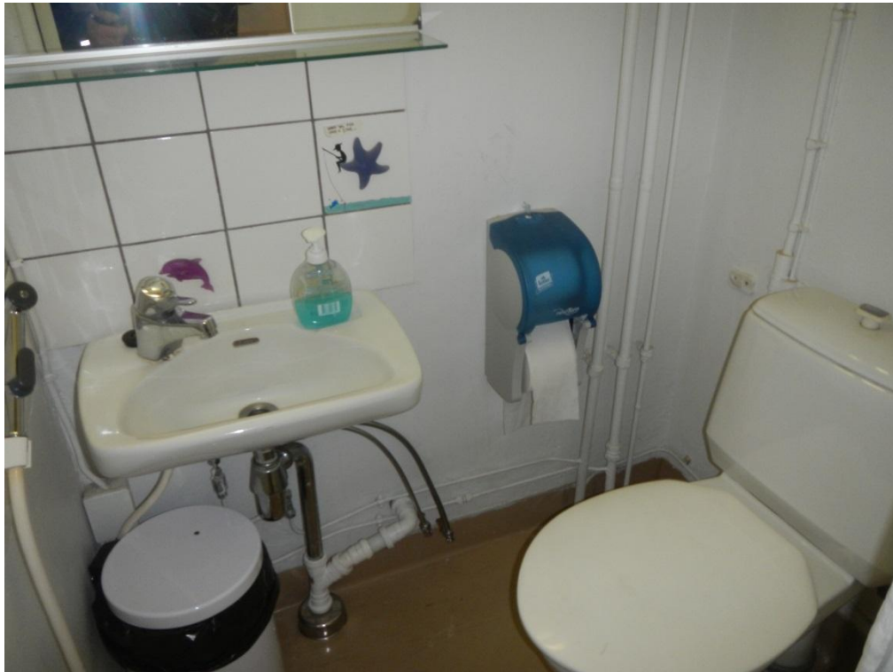
Kiinteistön tyypilliset vesi- ja viemärikalusteet.
