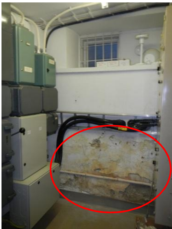
Sähköpääkeskuksen seinässä on kosteusvaurio.
