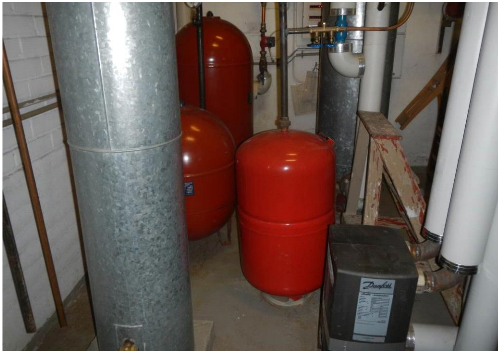
Yleiskuva kiinteistön lämmönjakokeskuksesta.
