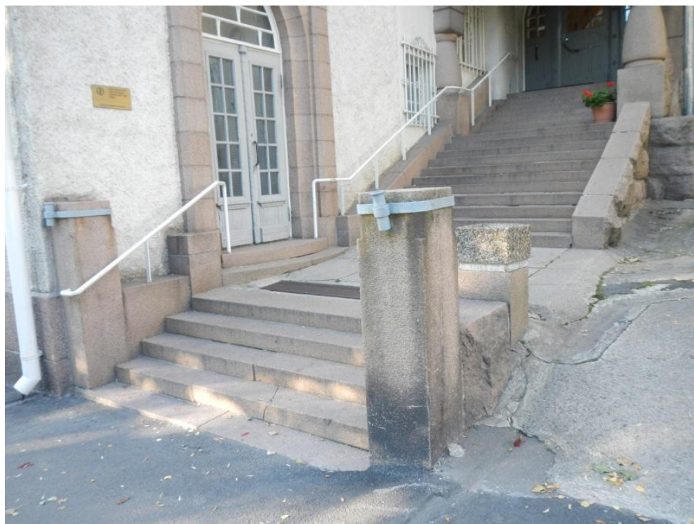
Yleiskuva pääsisäänkäynnin graniittiportaista. Betonoidulla alueella on halkeamia.
