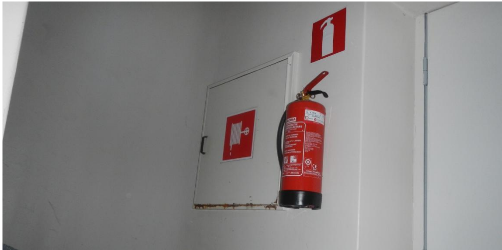
Yleiskuva porrashuoneen alkusammutuskalustosta.
