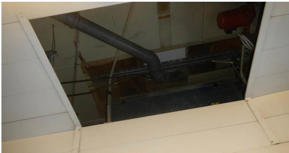
Keittiön ja ruokasalin tuloilmakone on asennettu keittiön välikattoon ja sitä on hankala huoltaa. Ilmanvaihtokone on teknisen käyttöään lopussa.
