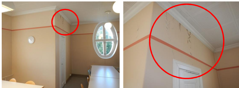
Yleiskuva luokkahuoneesta. Luokkahuoneen seinässä on vanha vesivaurio.
