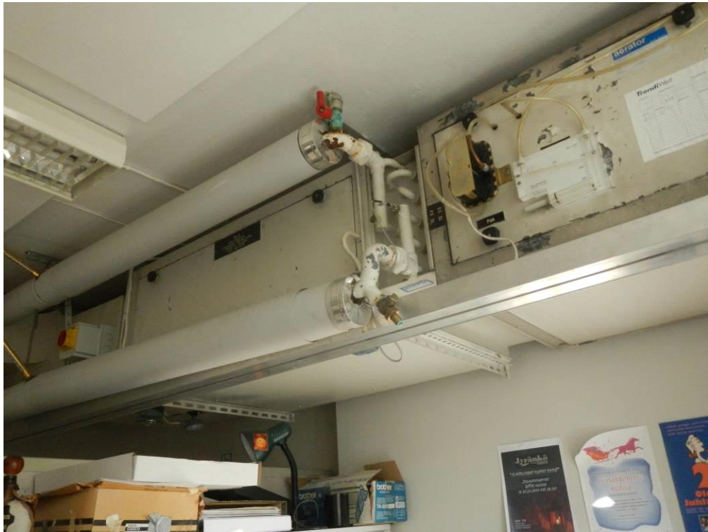
Keskiosan käsityöluokkia palveleva tuloilmakone. Ilmanvaihtokone on teknisen käyttöään lopussa.
