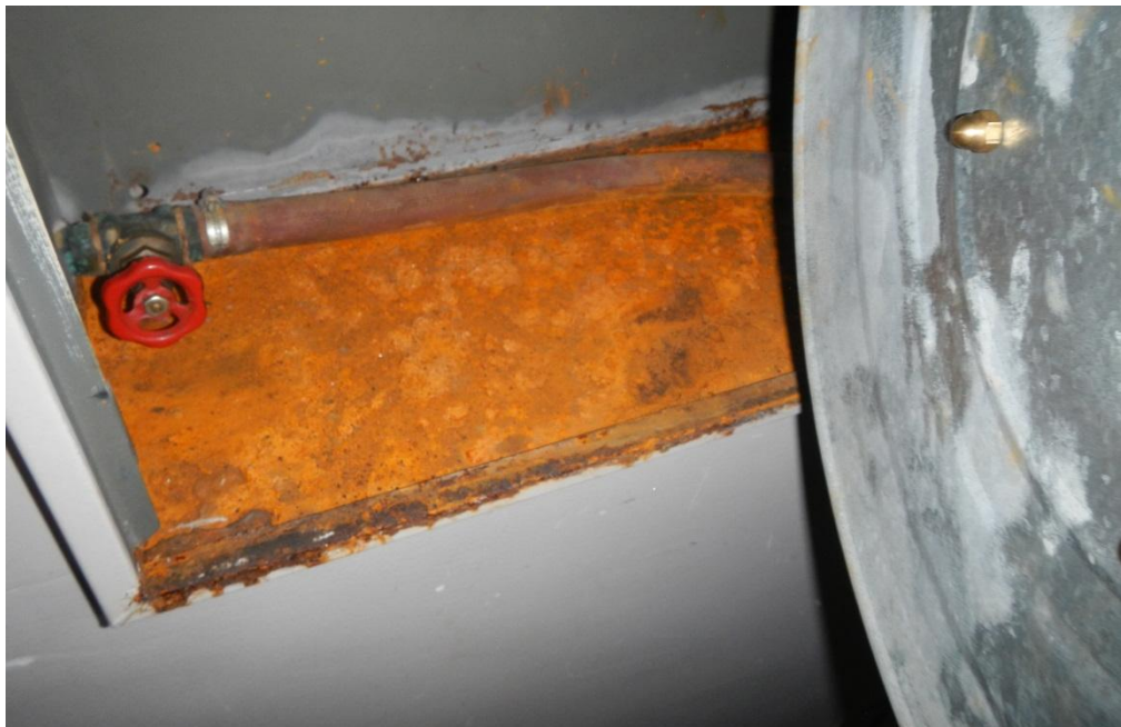
Pikapaloposteissa on havaittavissa vanhoja vuotojälkiä.
