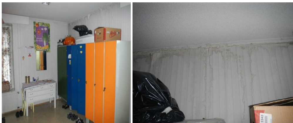
Yleiskuva siivoajien pukuhuoneesta. Seinässä on kosteuden aiheuttamia jälkiä.
