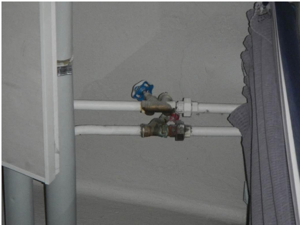
Yleiskuva lämpöjohtoverkostosta ja sulku- sekä linjasäätöventtiileistä, joiden karatiivisteet vuotavat.
