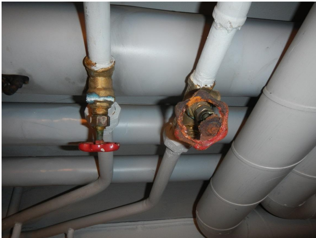
Kiinteistön lämpöjohtoverkoston vanhoja sulkuventtiileitä.
