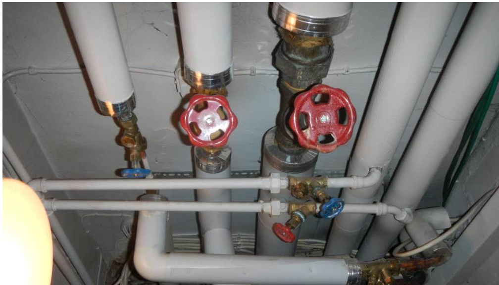
Yleiskuva kiinteistön käyttövesiverkoston venttiileistä.
