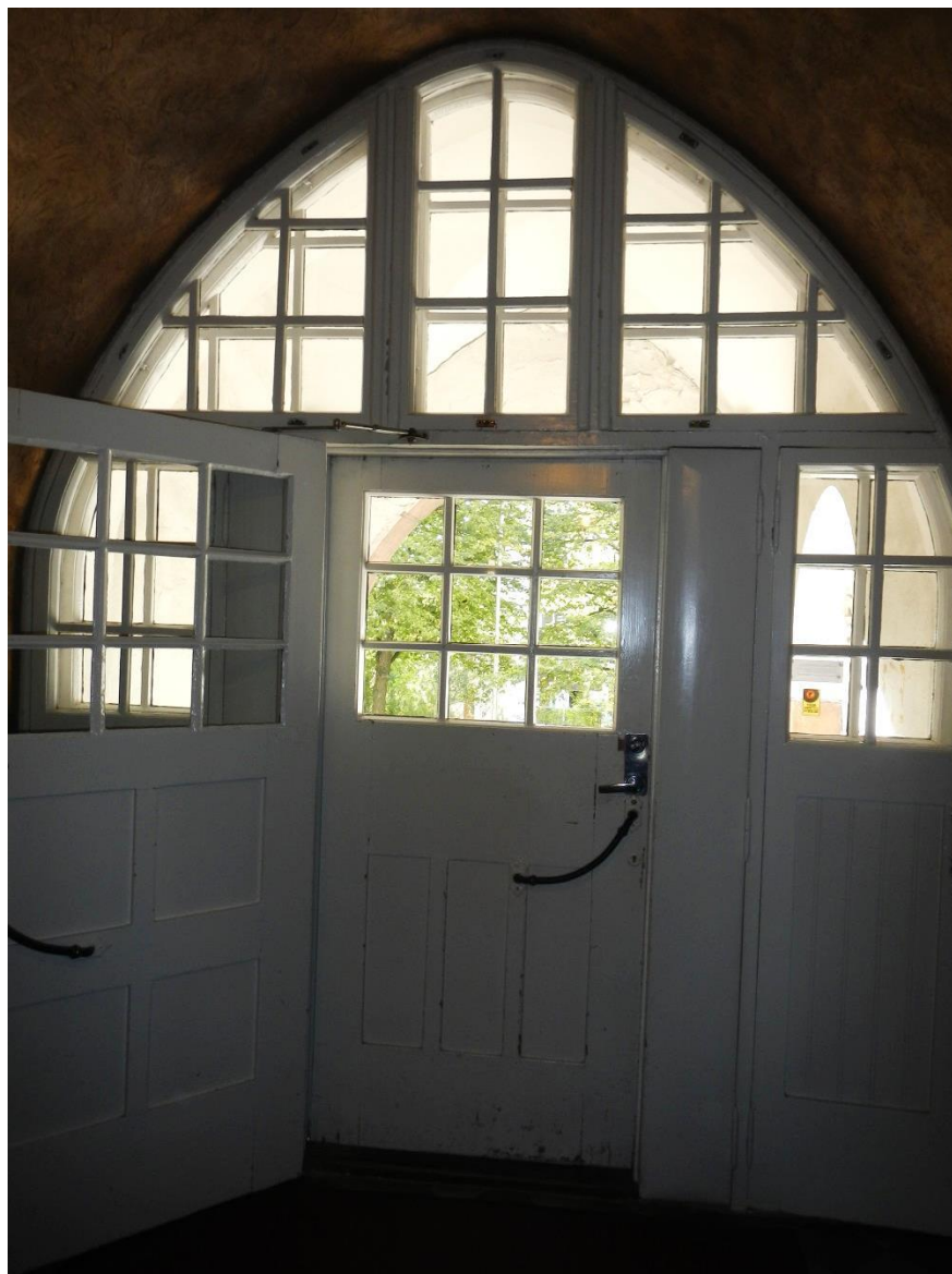
Yleiskuva ulko-ovesta, oven maalaus on kulunut.
