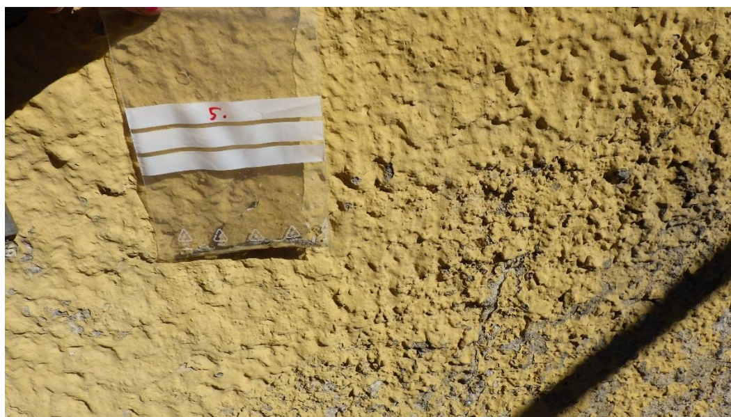
Kuva 8. Julkisivun maali ja rappaus (näyte 5). Ei sisällä asbestia.
