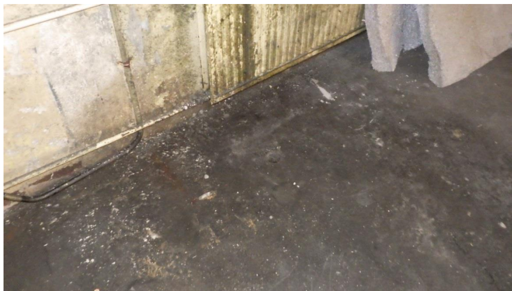
Kuva 3. Betonilattian porausnäytteen P1 öljyhiilivetypitoisuus 31500 mg/kg on korkea ja ylittää vaarallisen jätteen raja-arvon.
