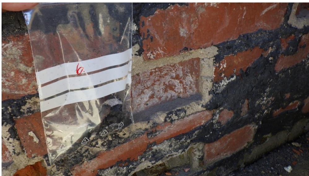
Kuva 2. Ulkoseinän bitumisively (näyte 6) PAH(16)-yhdistepitoisuus 78200 mg/kg on erittäin korkea ja ylittää vaarallisen jätteen raja-arvon
