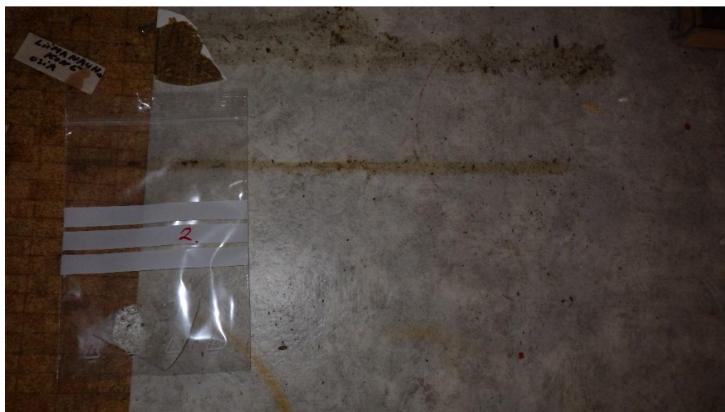
Kuva 5. Lattian vaalea muovimatto 2.krs (näyte 2). Ei sisällä asbestia.
