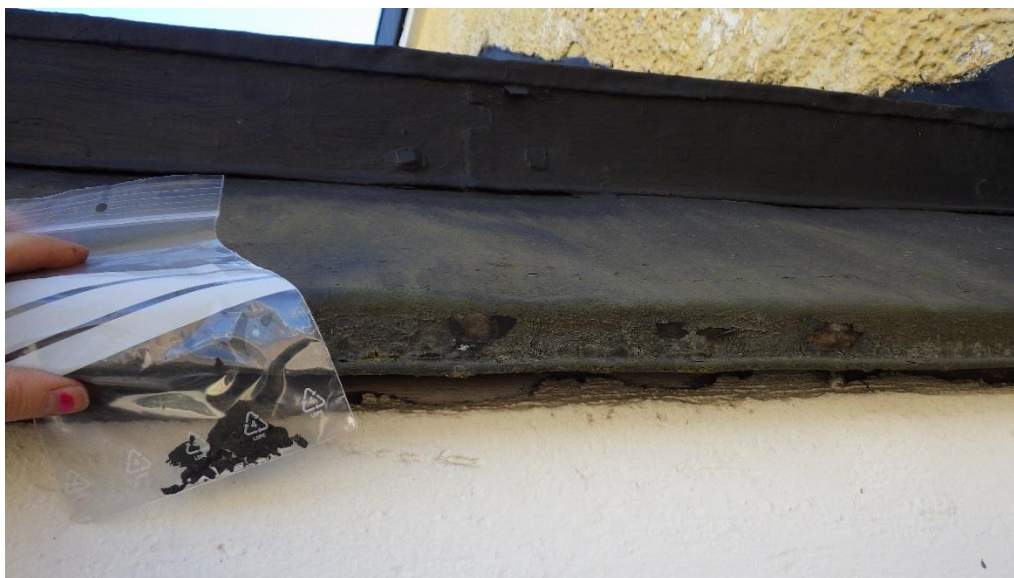
Kuva 1. Vesikaton maali (näyte 11) sisältää asbestia.
