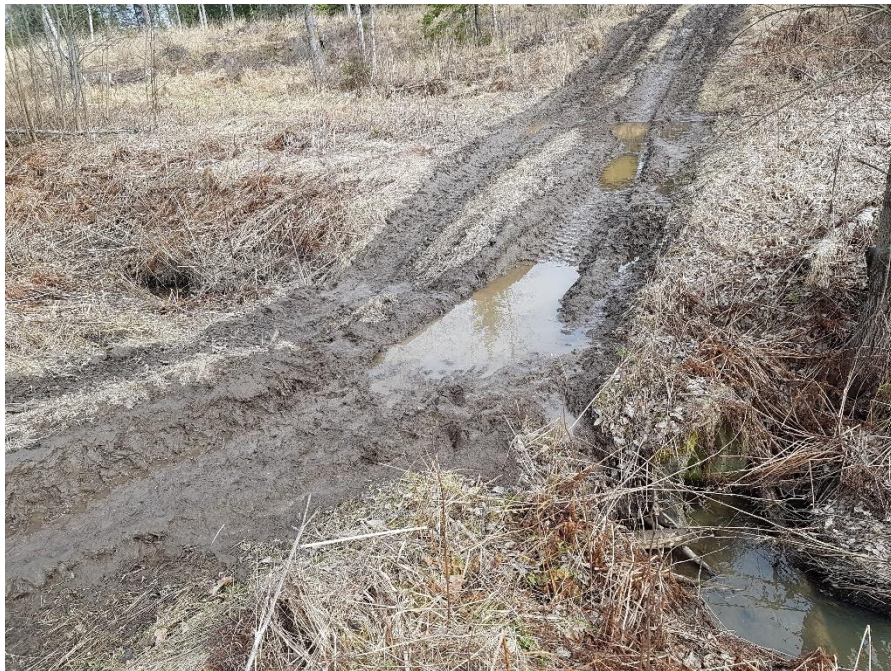
Kuva 6. Painunut 500B rumpu metsätien kohdalla Lintulantie 205 eteläpuolella
