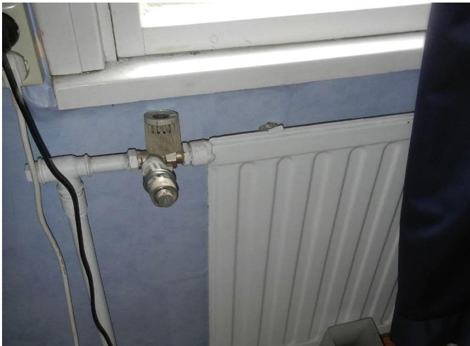
Omakotitalon patteriventtiilit ovat osittain teknisen käyttöään lopussa.
