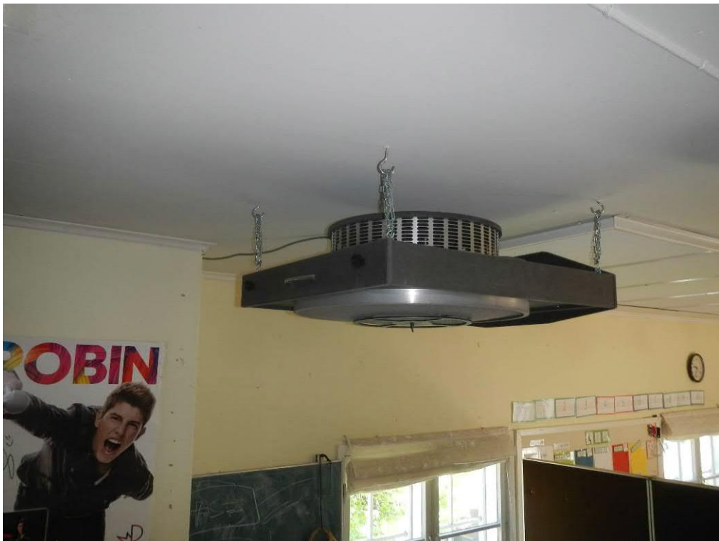
Ilmanpuhdistin päiväkodin tiloissa.
