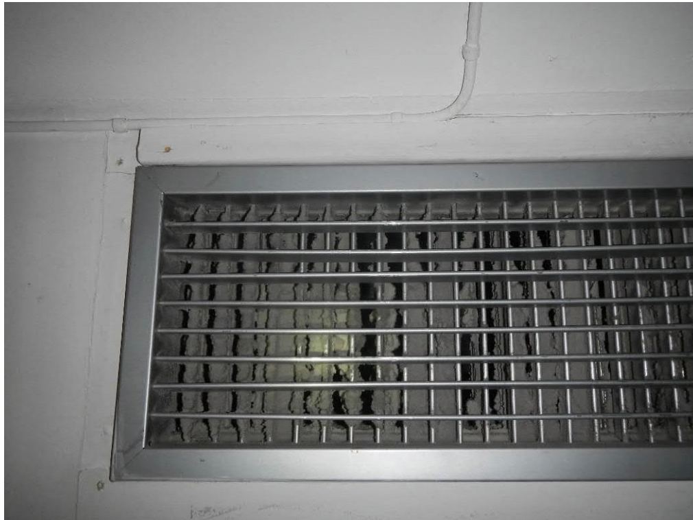
Rukoushuoneen ilmanvaihdon päätelaitteet ovat likaiset.
