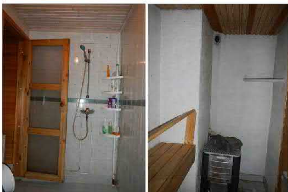
Omakotitalon saunan suihkutila ja löylyhuone ovat huonossa kunnossa. Löylyhuoneen seinän yläosassa on halkeama.
