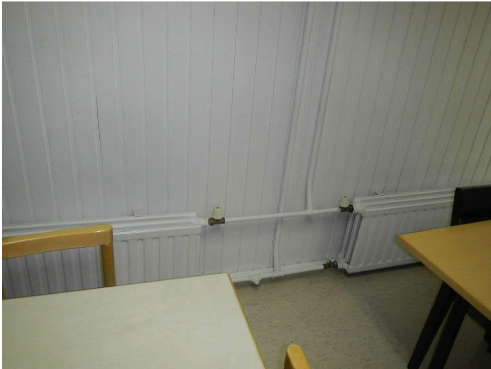
Rukoushuoneen patteriventtiilit ovat osittain käsisäätoventtiileitä.
