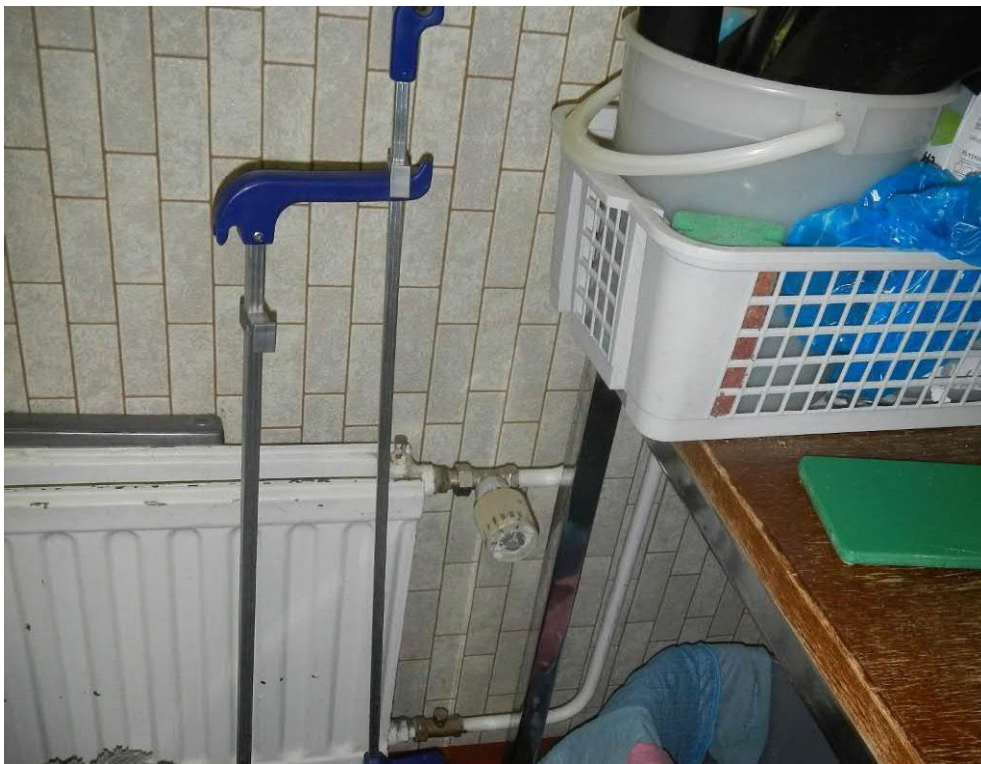
Rukoushuoneen patteriventtiilit ovat osittain teknisen käyttöään lopussa.
