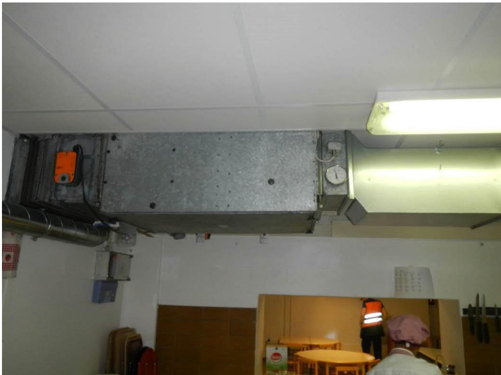
Rukoushuoneen keittiön tuloilmakone on teknisen käyttöään lopussa.
