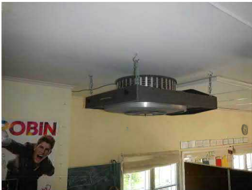
Ilmanpuhdistin päiväkodin tiloissa.
