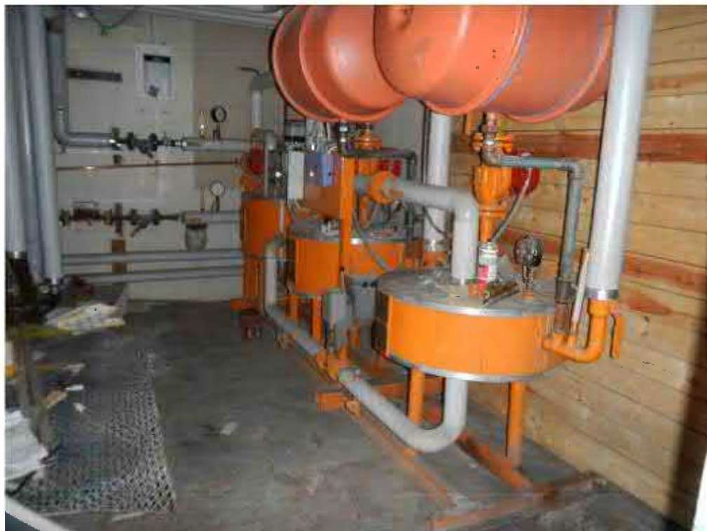
Rukoushuonetta ja omakotitaloa palvelevat lämmönsiirtimet ovat teknisen käyttöään lopussa.
