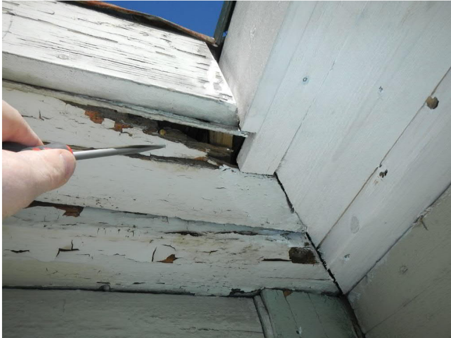
Rukoushuoneen räystäässä on havaittavissa pieniä lahoalueita.
