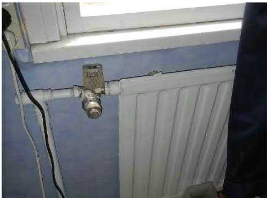
Omakotitalon patteriventtiilit ovat osittain teknisen käyttöään lopussa.
