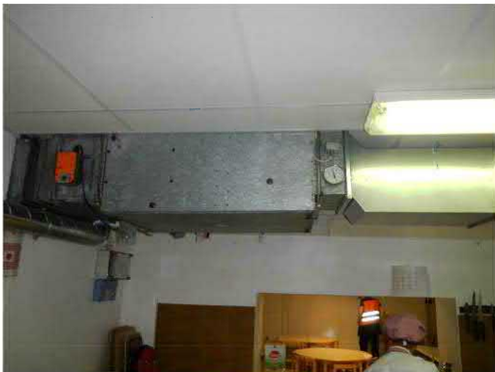
Rukoushuoneen keittiön tuloilmakone on teknisen käyttöään lopussa.
