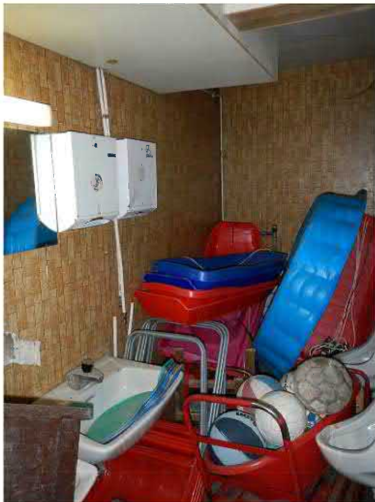
Osa rukoushuoneen märkätiloista on huonossa kunnossa.
