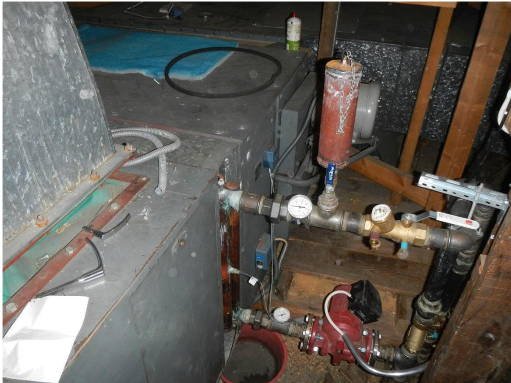
Rukoushuoneen IV- kone on heikossa kunnossa ja teknisen käyttöään lopussa.
