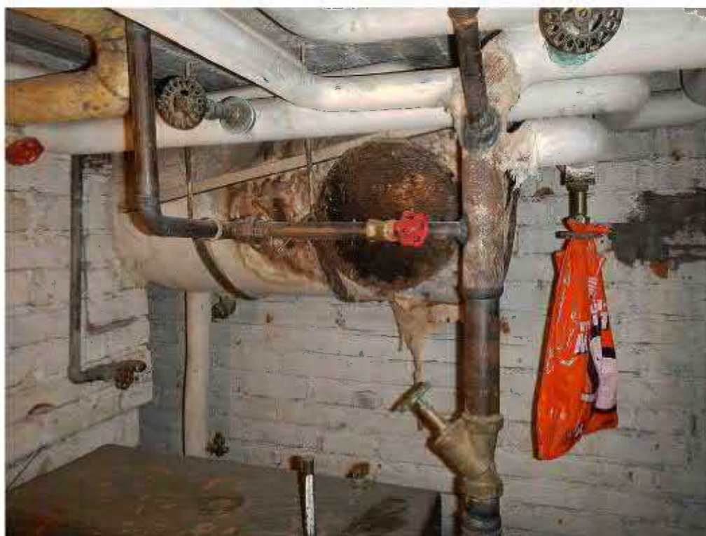
Omakotitalon kellarissa on rikkiäistä asbestieristettä.
