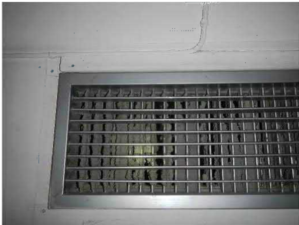
Rukoushuoneen ilmanvaihdon päätelaitteet ovat likaiset.
