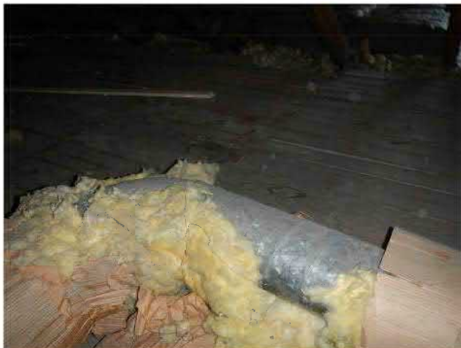
Rukoushuoneen ullakolla IV-kanavien eristys on puutteellinen.
